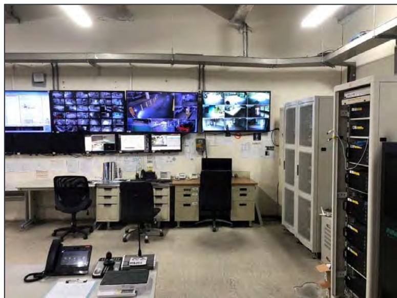
臺南園區廠房內副機房
