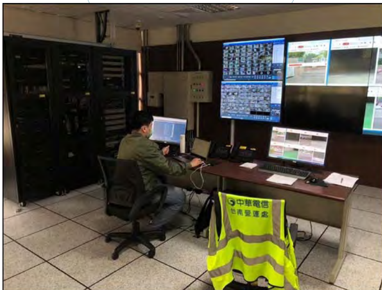
臺南園區系統中控室
