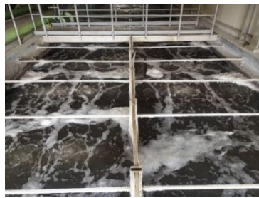
一期基地硝化接觸曝氣池
