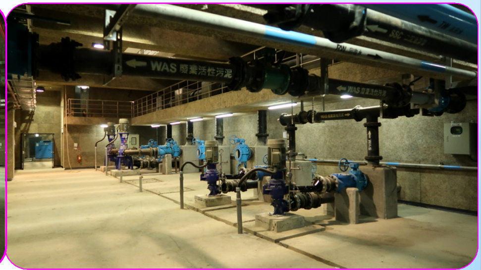
機械設備工程(回流與廢棄污泥泵)
