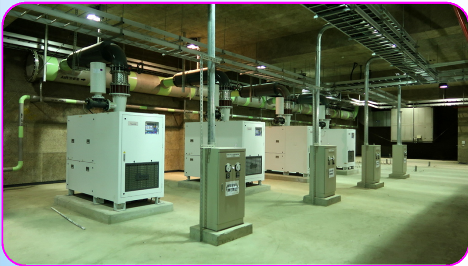
機械設備工程(單段離心式鼓風機)
