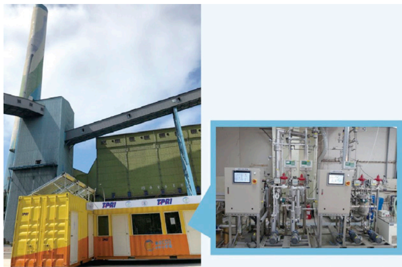
圖 3-9 台中電廠減碳技術園區 - CO 2 捕獲驗證場域
